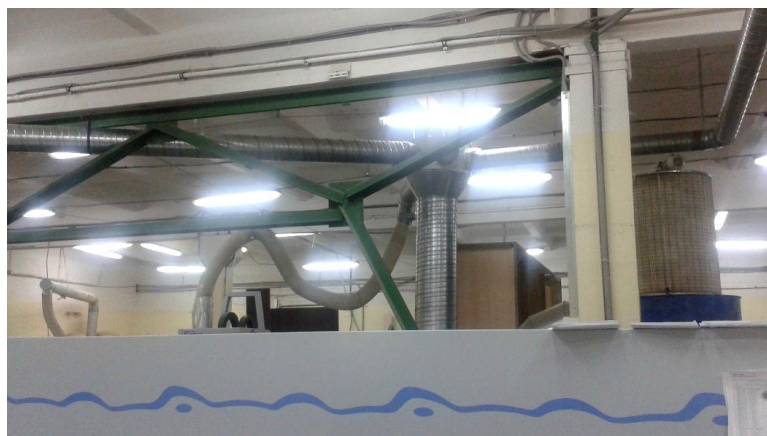
Рис. 7. Общий вид подключения станков к системе К2 через коллектор с отводами
