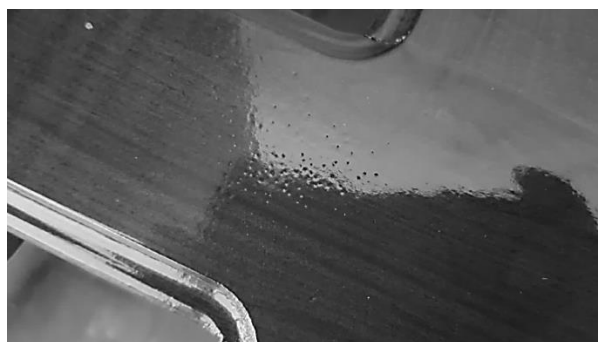
Рис. 2. Шагрень на лакокрасочном покрытии
