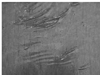
Рис. 4. Сморщивание лакокрасочного покрытия
