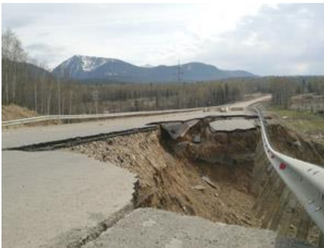
Рис. 1. Провал дорожного полотна вследствие оттаивания вечномерзлого грунта
