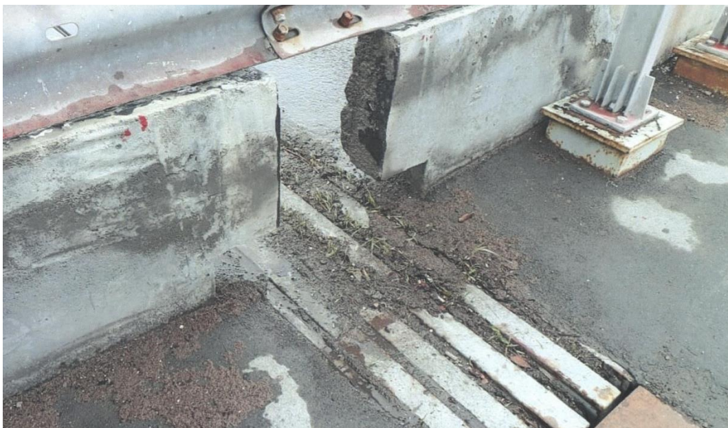
Рис. 3. Нарушение правил содержания деформационного шва моста
