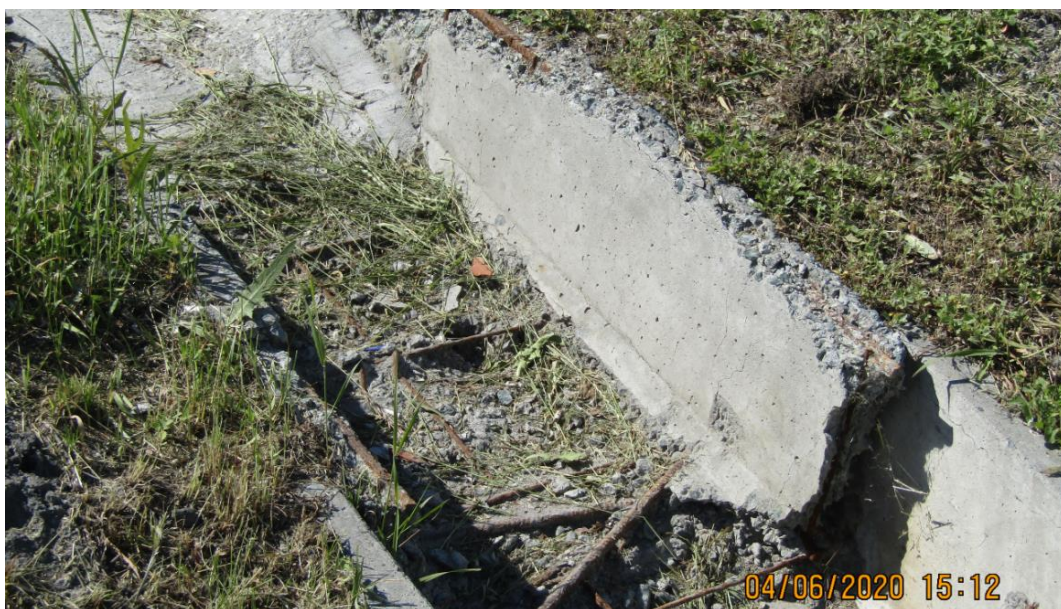
Рис. 2. Разрушение железобетона телескопического лотка
