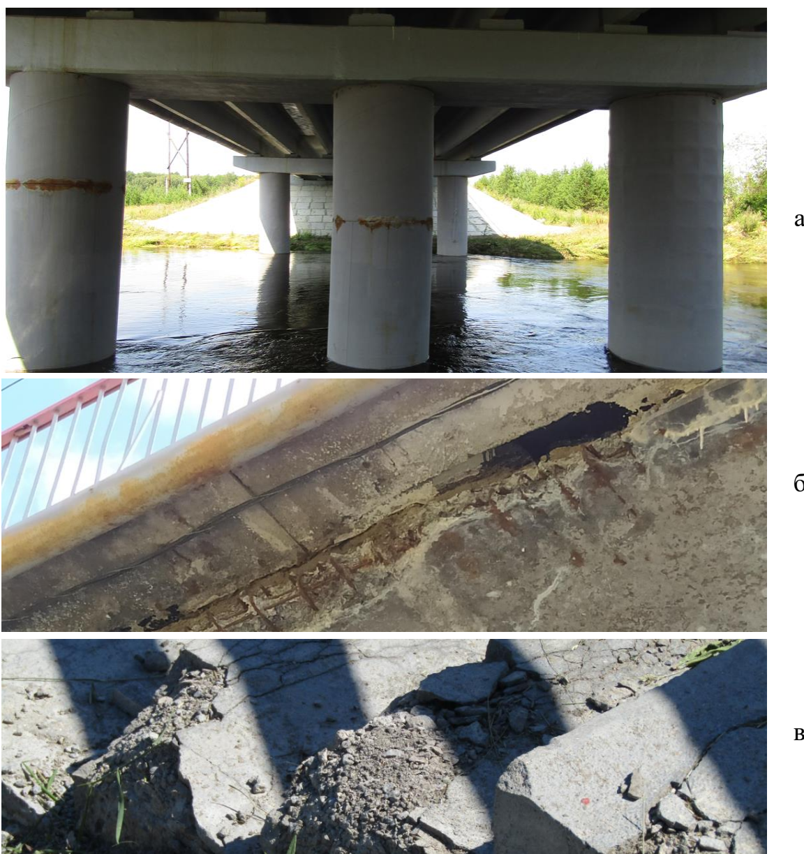
Рис. 1. Примеры разрушений бетонных и железобетонных конструкций автомобильного моста: трещины на промежуточных опорах (а); разрушение консольных тротуарных блоков (б); разрушение бетона лестничных сходов (в)
