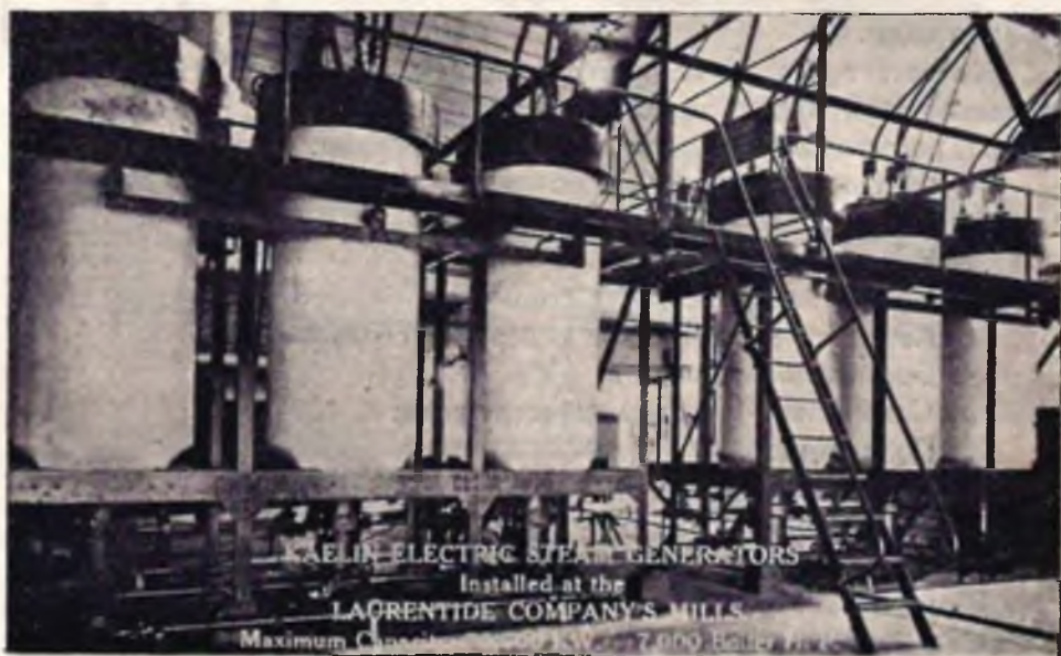
Внутренний вид электрической котельной на фабрике Laurentide Comp. в Канаде.
