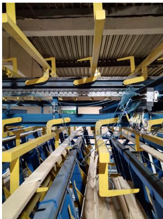
Рис. 2. Повреждение системы пневмопривода
