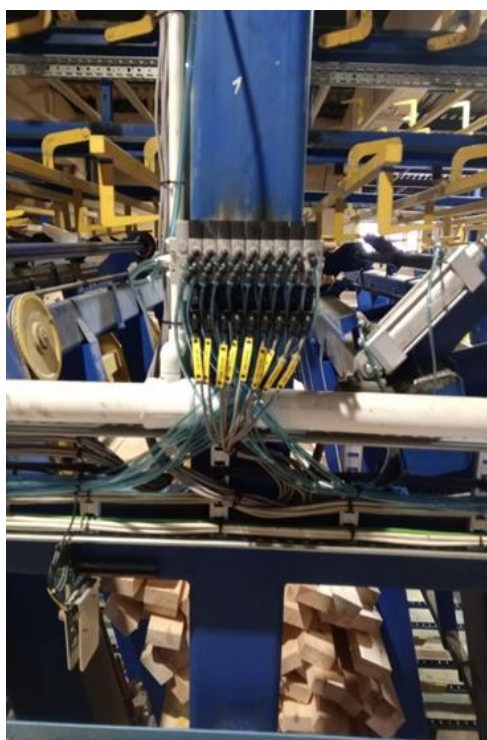
Рис. 3. Система распределителей пневмопривода на площадке обслуживания
