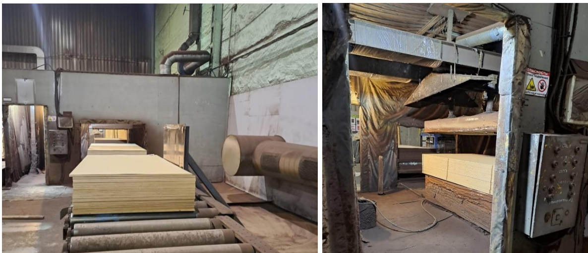
Рис. 4.33. Камера покраски кромок фанеры в стопе
