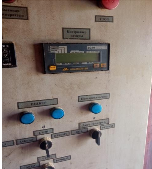
Рис. 8. Пример контроллера с психрометрическим способом измерения влажности воздуха и измерением влажности древесины
