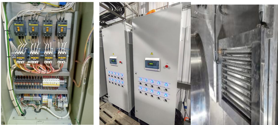
Рис. 12. Силовая коммутация тэнов. Шкаф управления с отдельным контроллером. Сам тэн с датчиком контроля собственной температуры
