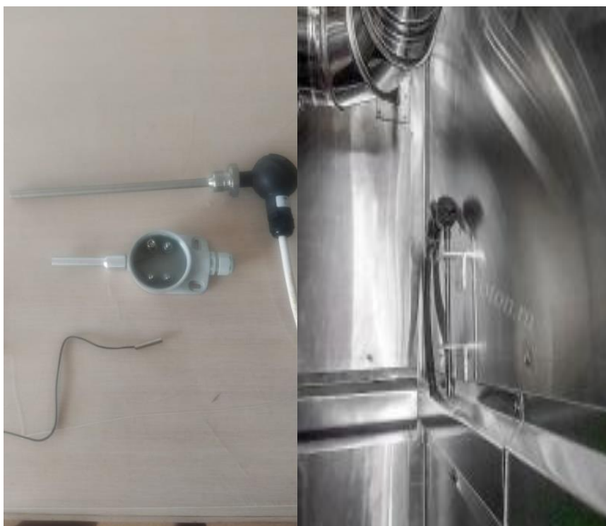
Рис. 18. Примеры датчиков. Установленный в камере датчик температуры воздуха
