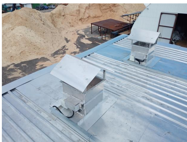
Рис. 6. Вентиляционные колодцы с жалюзи и поворотным электроприводом 3
