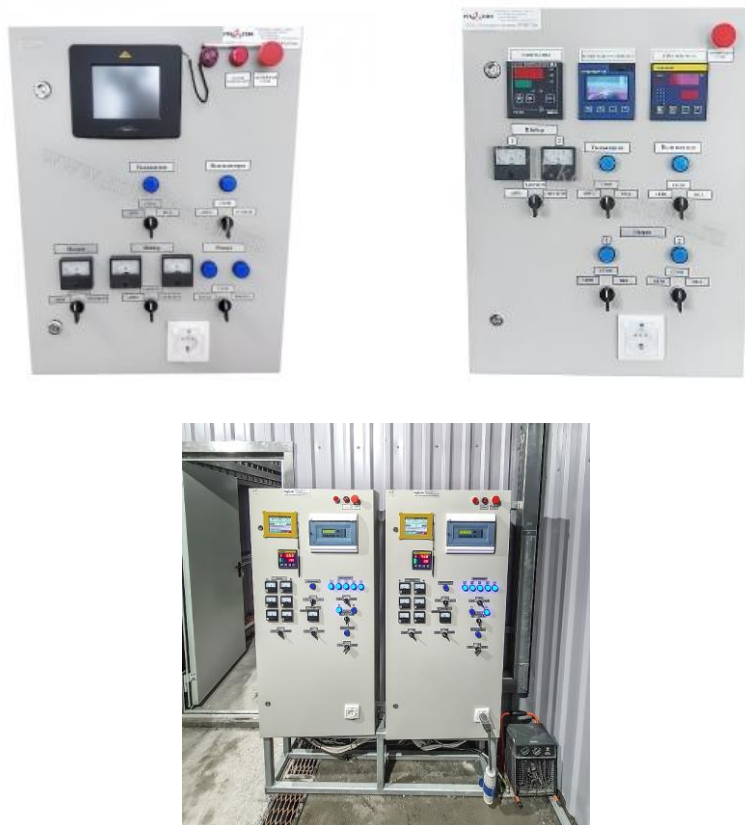
Рис. 29. Примеры шкафов систем автоматики лесосушильных камер 6
