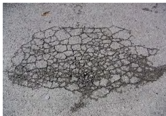
Рис. 2. Сетка трещин асфальтобетонного покрытия
