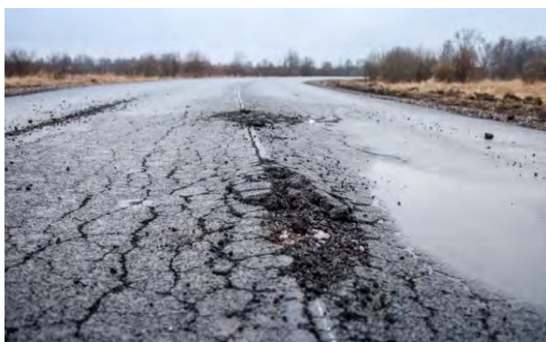
Рис. 1. Разрушенные бугры пучины
