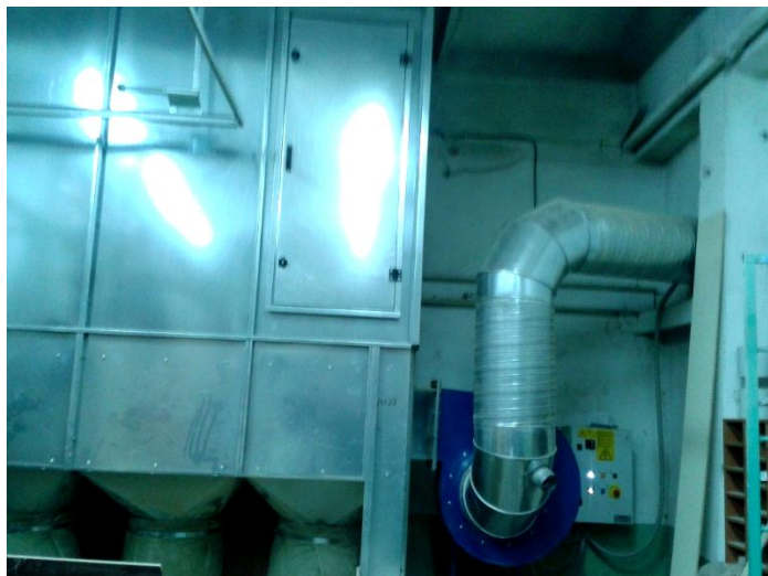
Рис. 6. Аспирационная установка с рукавными фильтрами (Coima, Италия) для удаления отходов от HOLZMA HPP 350/32/32, вынесенная в отдельное помещение
